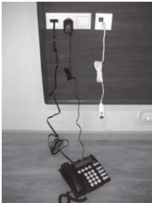
Alarmas, teléfono, Wifi y ADSL.
